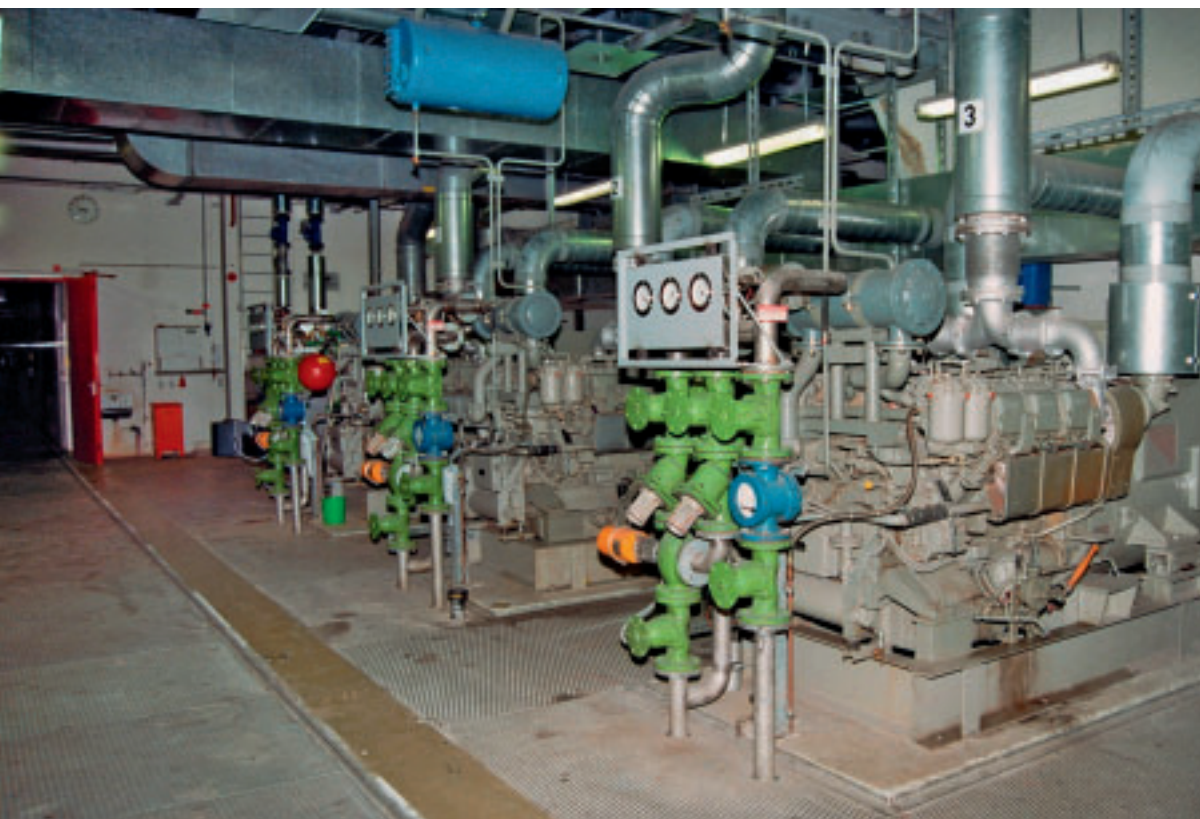
5 Maschinenraum im Sanitätshauptdepot.
